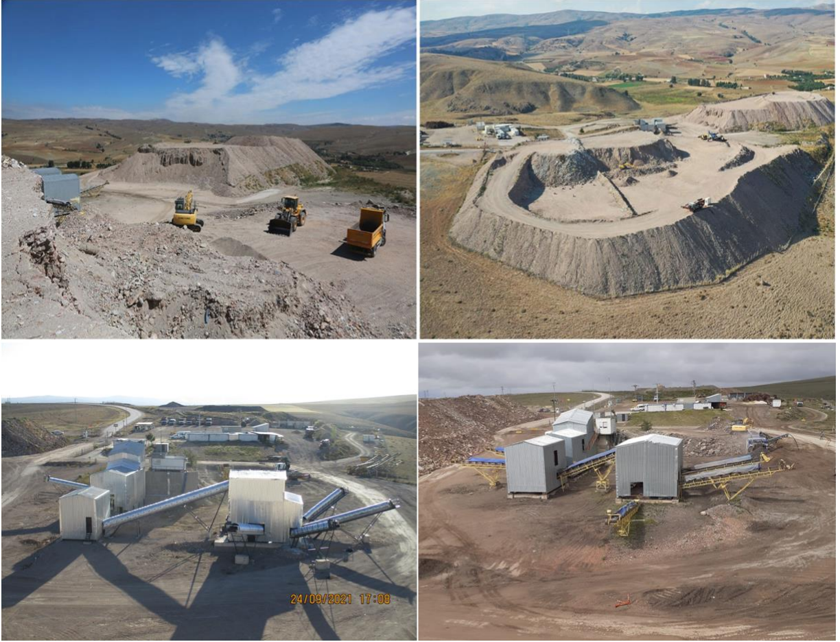
Şekil 20. Eskişehir Büyükşehir Belediyesi inşaat ve yıkıntı atıkları geri dönüşüm tesisi
